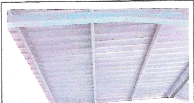
Foto 1: Aula No.3. Agujeros y filtración de agua en el techo
