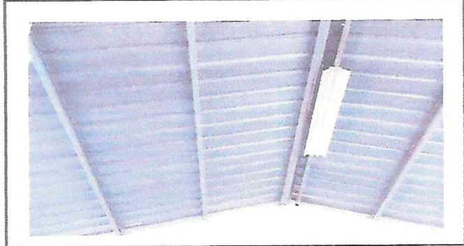
Foto 2: Aula No.3 Agujeros en el techo
